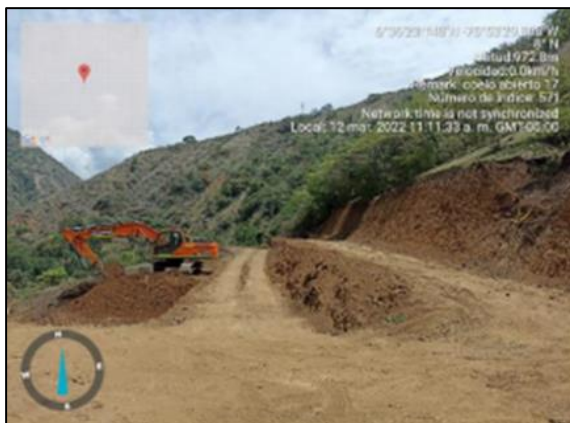
Foto 4-5 K15+246 – K15+506, estado inicial
