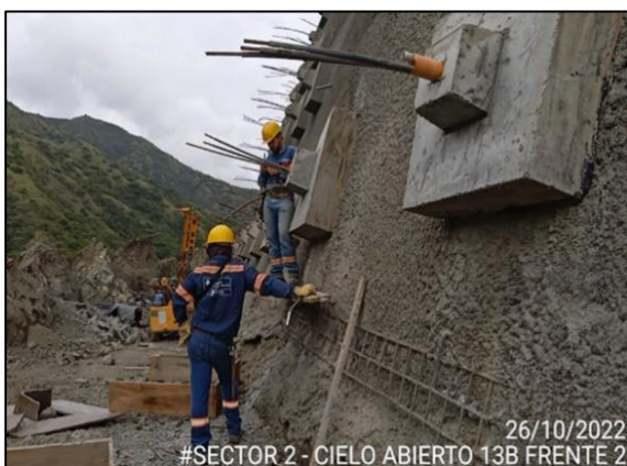
Foto 4-3 K12+356 -K13+664, estado inicial
