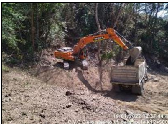
Foto 4-1 K12+356 -K13+664, estado inicial
