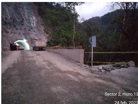
Foto 4-09 Cielo abierto 12, muro 13, falta construcción de new jersey
