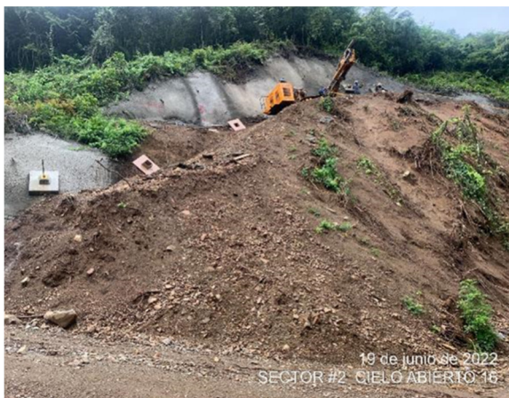
Foto 47 K14+330 –K14+670, estado inicial
