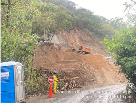
Foto 45 K14+030 –K14+200, estado inicial
