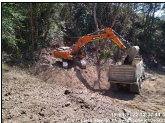
Foto 4-1 K12+356 -K13+664, estado inicial
