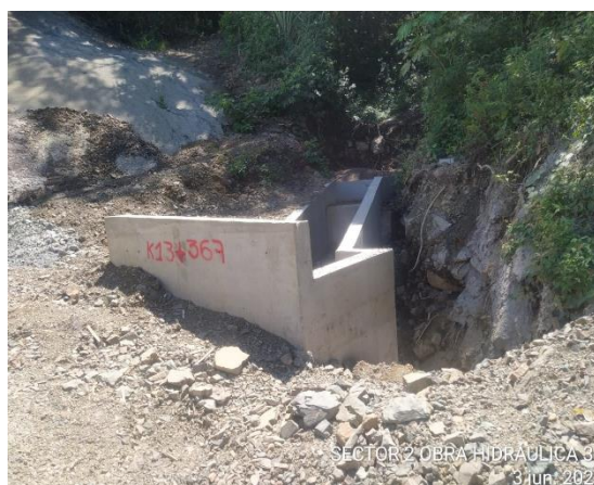
Foto 4-30 Obra hidráulica No 39 frente inactivo
