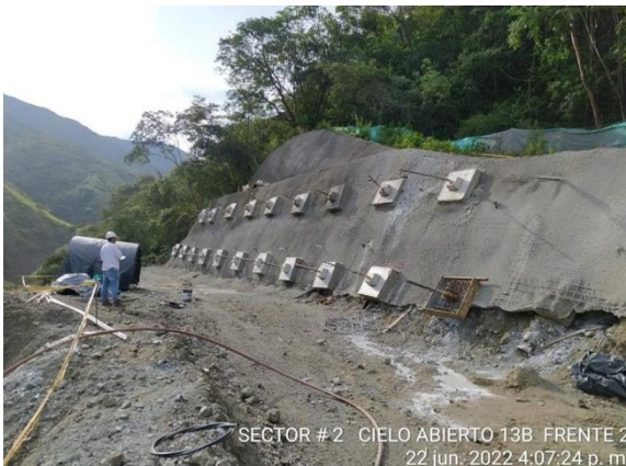
Foto 4-3 K12+356 -K13+664, estado inicial
