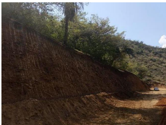
Foto 4-9 K15+246 – K15+506, estado inicial
