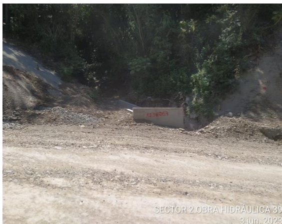
Foto 4-29 Obra hidráulica No 39 box Colbert de 2x2 frente inactivo
