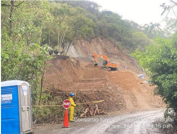
Foto 4-5 K14+030 –K14+200, estado inicial
