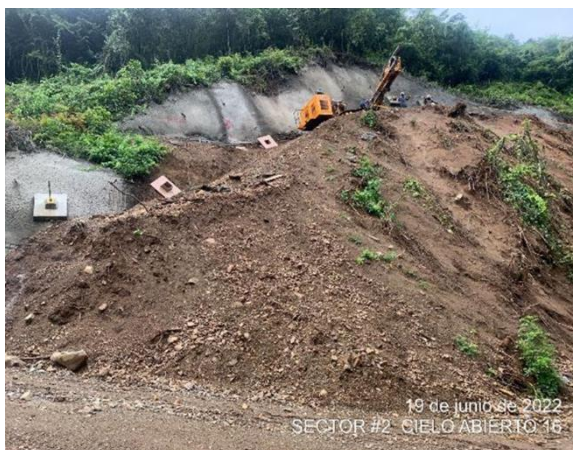
Foto 4-7 K14+330 –K14+670, estado inicial
