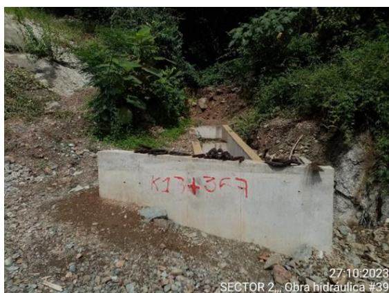
Foto 4-27 Obra hidráulica No 39 box Culvert de 2x2 frente inactivo falta descole
