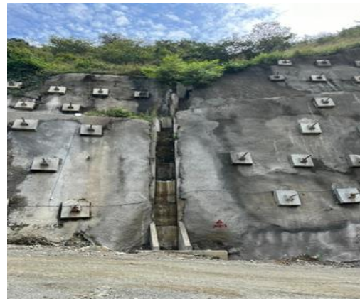
Foto 4-50 Obra hidráulica No 47 alcantarilla de 1200mm frente inactivo falta descole
