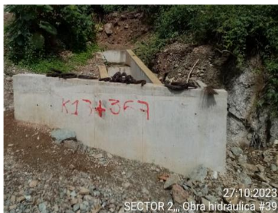
Foto 4-28 Obra hidráulica No 39 frente inactiva falta descole
