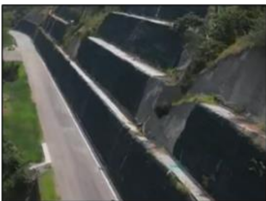
Foto 3-5 Estado actual K3+050 – K3+330
