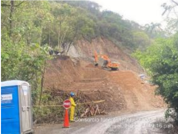
Foto 4-5 K14+030 –K14+200, estado inicial
