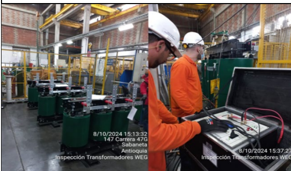
Fotografía No. 7 – Inspección Transformadores WEG, el 8 de octubre de 2024
