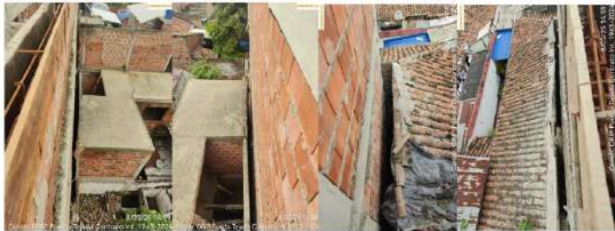
Ilustración 8 Fachadas sin flanches metálicos
