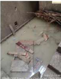
Ilustración 4. Empozamientos de agua matera área escalera (afectan pañetes).
