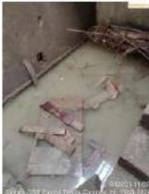
Ilustración 4. Empozamientos de agua materia área escalera (afectar pañetes).
