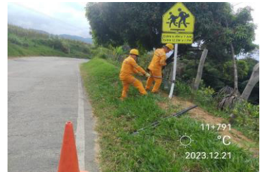
ARREGLO DE SEÑALES VERTICALES PR 11+0791
