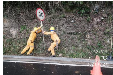
ARREGLO DE SEÑALES VERTICALES PR 32+0812
