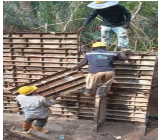
Falta de condición de seguridad para prevenir la caída en distinto nivel
