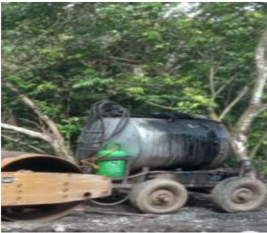
Falta demarcación, señalización de productos químicos
