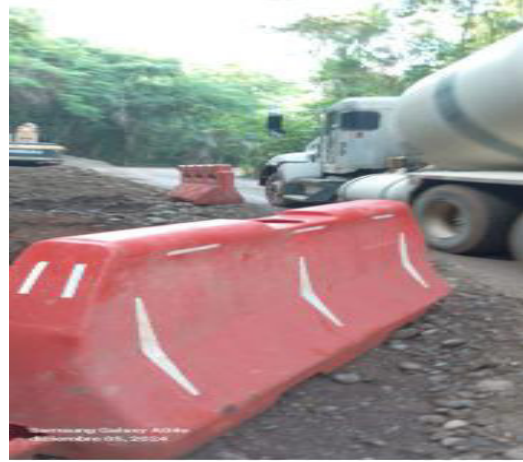
Peligro: personal en áreas de excavación
