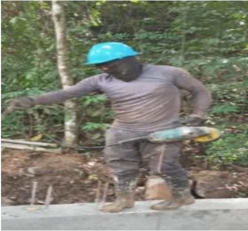
Trabajo en caliente: pulidora sin la guarda
