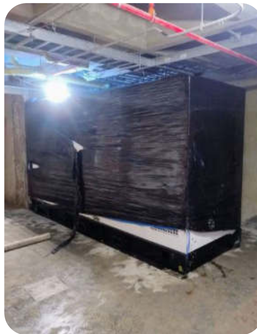
Ubicación planta eléctrica
