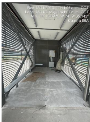
Ilustración 2: Cuarto de Generador Taquilla Tipo 2 Troncal Av. Ciudad de Cali
