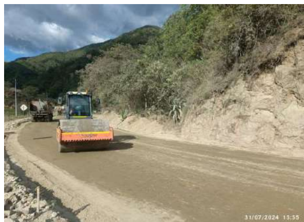
Fotografía 2: Cereo de base granular en el frente del PR52+200.
