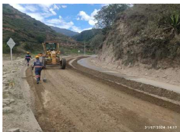
Fotografía 1: Cereo de base granular en el frente del PR52+200.
