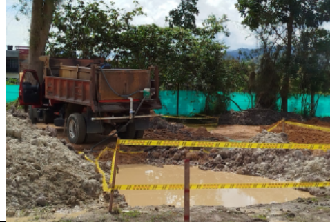
Fotografía No 26: AFECTACIONES EN POZOS DE ACHIQUE
