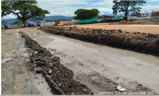
Fotografía No 25: AFECTACIONES POR LLUVIAS
