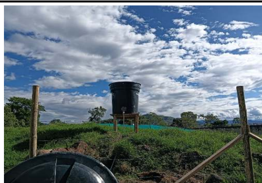
a.1. Agua potable - Tanque de reserva
