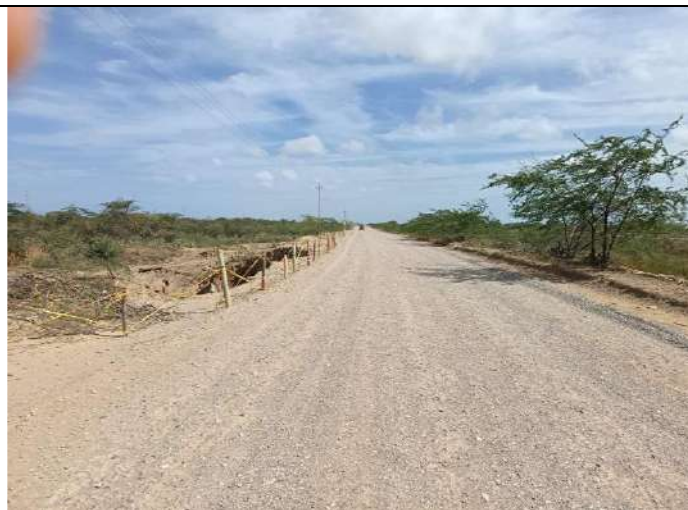
Alcantarilla sin intervenir señalizada Pr 100+000
