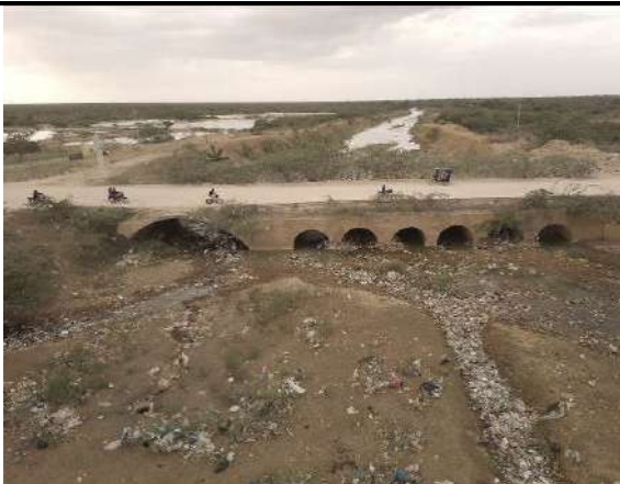
Fotografía 1: Estado inicial antes del inicio de la intervención Pte. Chemerrain Tramo Uribia - Puerto Bolívar
