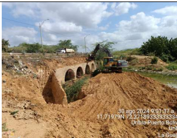
Fotografía 5: Estado inicial de alcantarilla Pr 77+660, Tramo Uribia- Puerto Bolívar
