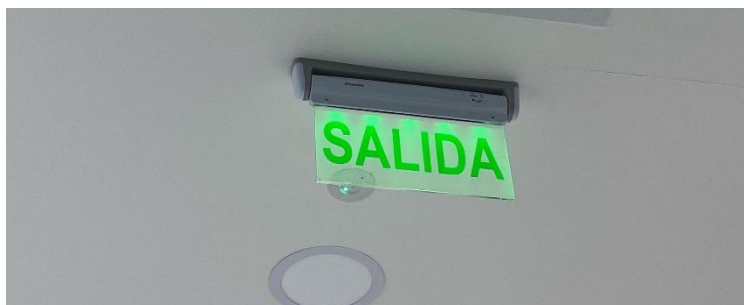
LUMINARIA AVISO LUMINOSO DE SALIDA DE EMERGENCIA
