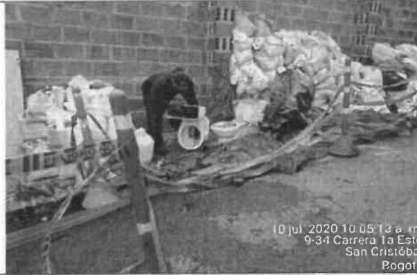
Foto No. 16. Se revisó y verificó la gestión de disposición de residuos especiales (Unidades sanitarias), sede IMPRENTA DISTRITAL.
