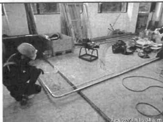
Foto No. 39 Se revisó y verificó las condiciones de orden y aseo en el área del cuarto oscuro sede IMPRENTA DISTRITAL
