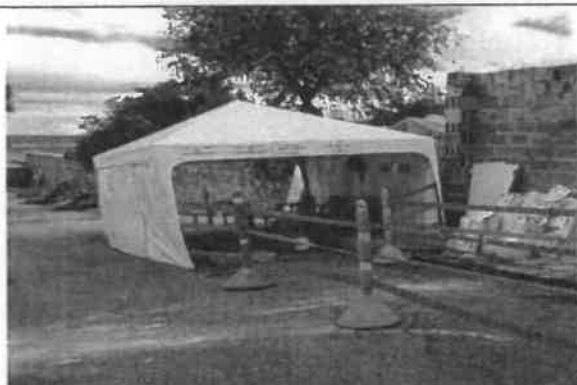
Foto No. 17. Se revisó y verificó la señalización del puesto de control frente al protocolo de ingreso - PROTOCOLO DE BIOSEGURIDAD, sede IMPRENTA DISTRITAL.
