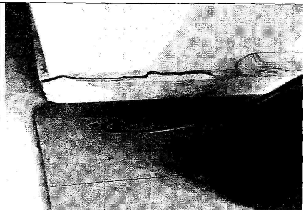
Evidencia N° 2: sede olivos guarda escoba al lado del digiturno, este suelto se recomienda el mantenimiento.
