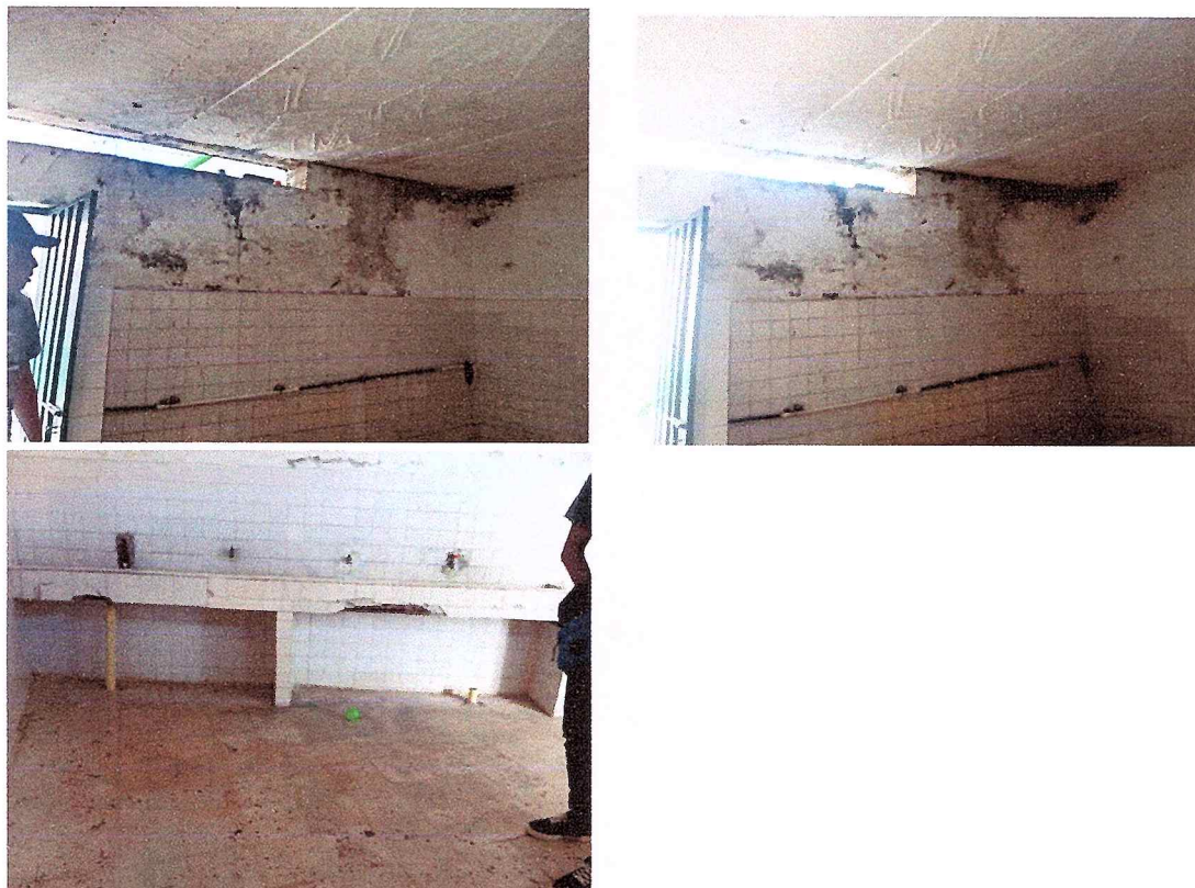
Figuras 1.3. Actual estado de los baños
