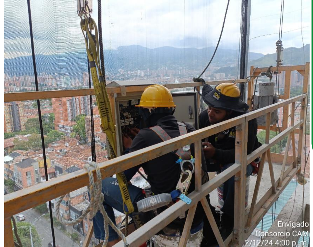
Mantenimiento periódico de andamios colgantes.
