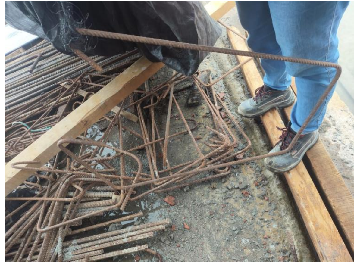
Incidente con caída de un estribo de acero en techo colindante.
