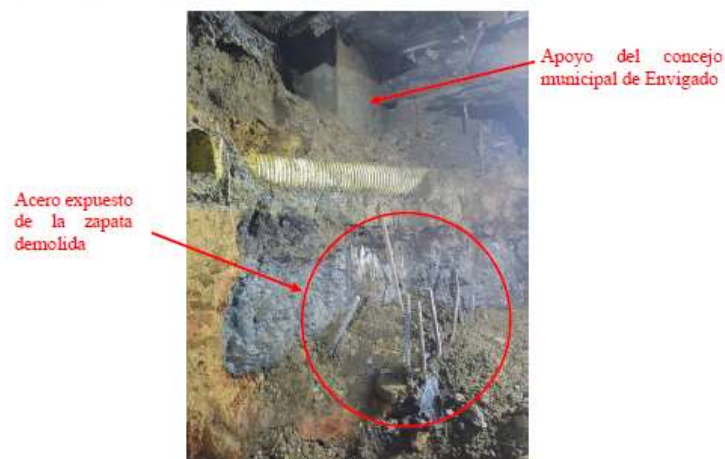
Figura 1. Zapata afecta en el sótano 2.5 de torre norte.
