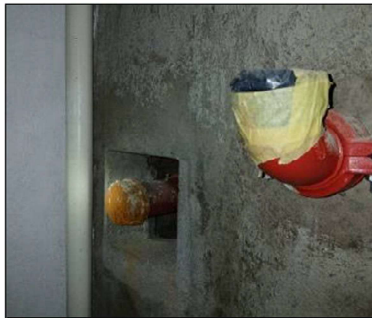
Se debe instalar sellos corta fuego en todos los pases de tubería horizontales
