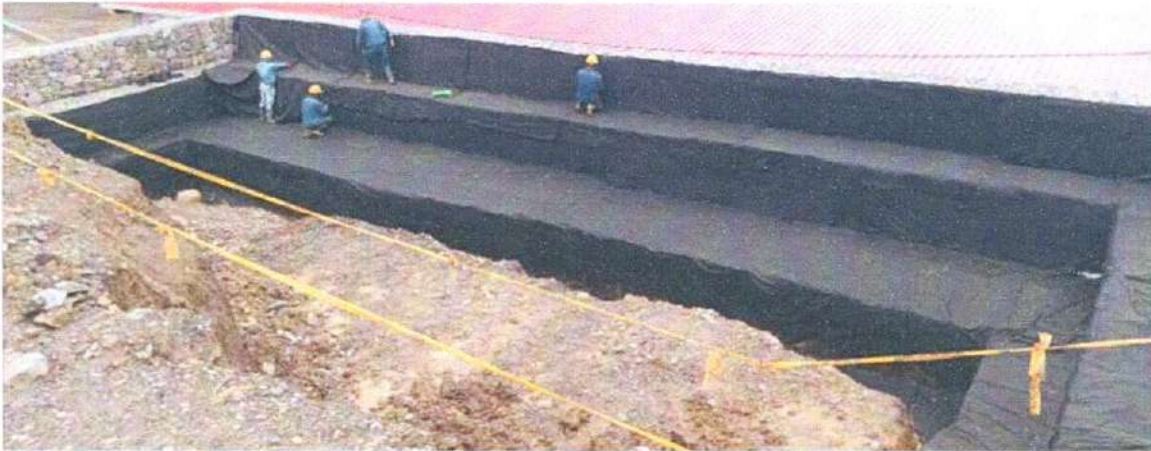
Ilustración 7 Muro de contención en gavión con geotextil módulo D
