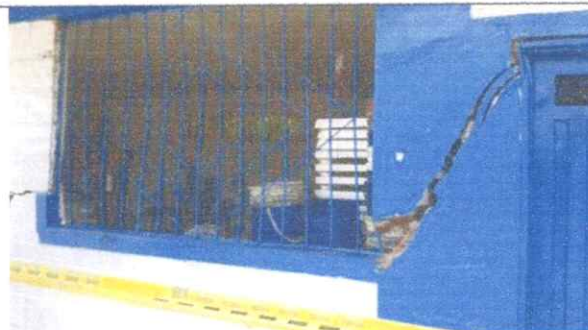
Imagen 3: afectación en muros ventana y puerta de uno de los salones del primer piso.
