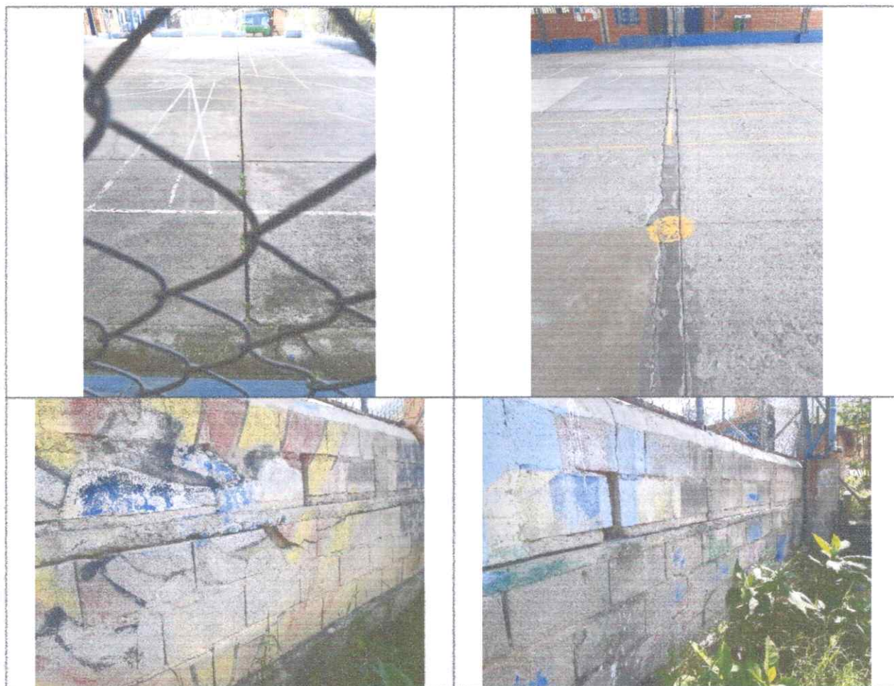
Imagen 10 a 13: evidencias de inestabilidad (grietas y deformaciones), en losa y muros de la placa deportiva de la I.E.
