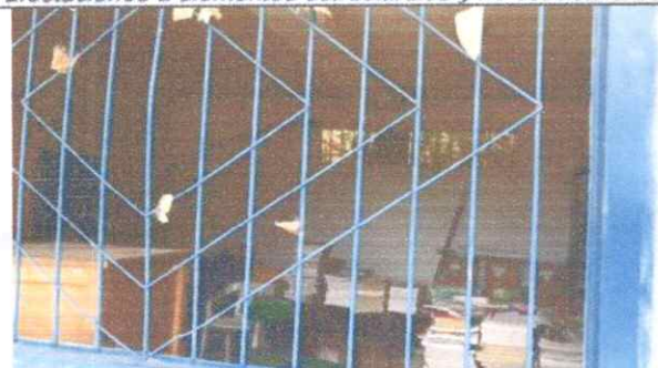
Imagen 4 y 5: afectación de uno de los salones, donde aún ingresan personas ocasionalmente
