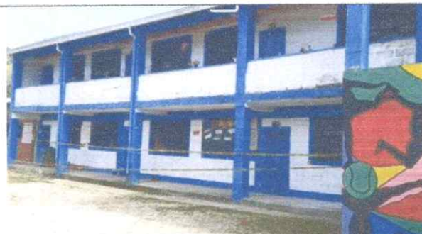
Imagen 2: panorámica del bloque 1 donde se observan afectaciones a elementos estructurales y no estructurales.
