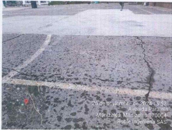
Ilustración 14 Fisuras Encontradas en losas cancha #4
