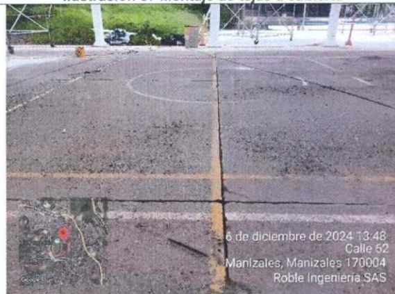
Ilustración 59 Fisuras y juntas cancha #3
