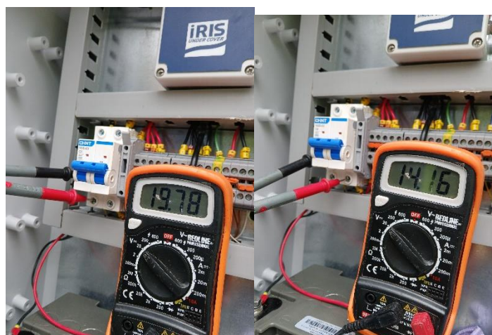
Figura 9. Toma de voltaje a panel solar y batería correspondientemente.
