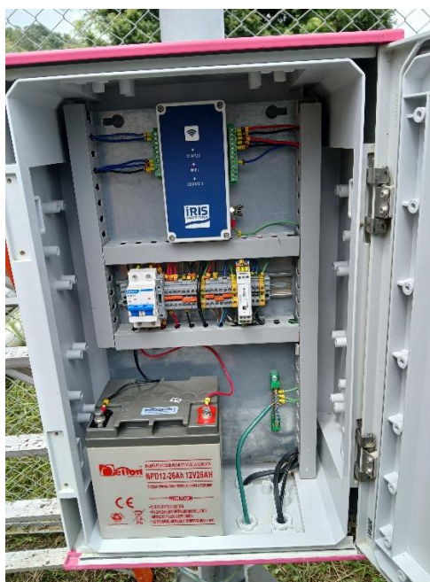
Figura 7. Revisión de tablero eléctrico, limpieza y ajuste de conexiones.
