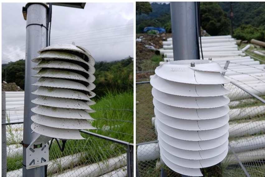
Figura 6. Condición del Termohigrómetro antes y después del mantenimiento.
