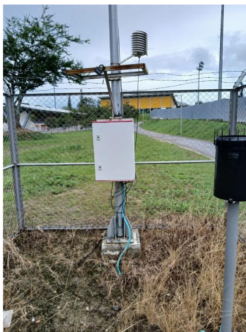
Figura 3. Condiciones Estación Parque Deportivo IMDRI antes del mantenimiento.
