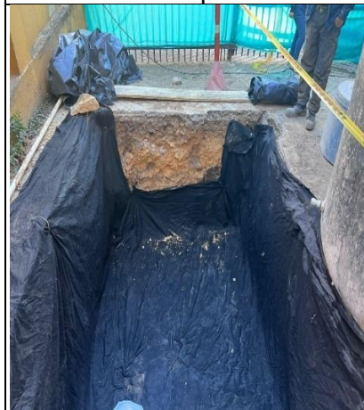
Impermeabilización del poso de lodos
