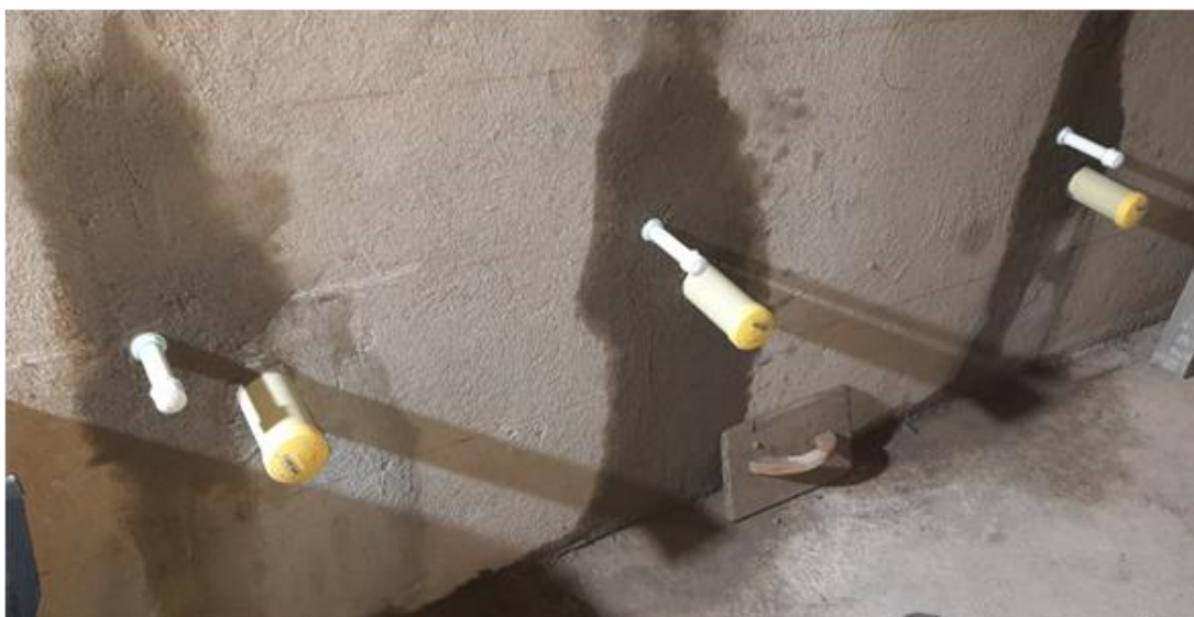
Imagen 12. Instalaciones hidrosanitarias para lavamanos URI.
