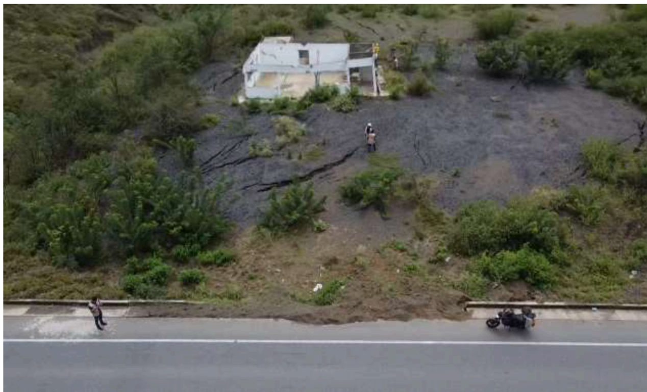
VISITA TECNICA, HUNDIMIENTO POR FALLA GEOLOGICA RUTA 2502, SECTOR EL REMOLINO
