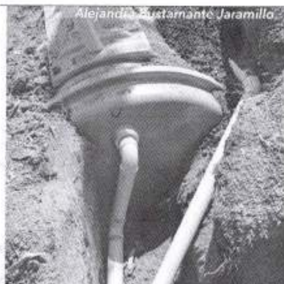
Figura 14. Cámara de captación de agua
