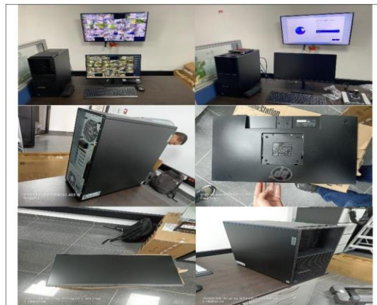
Visual Cámaras en CCM
