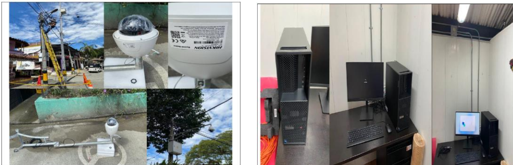
Cámaras en CCM
