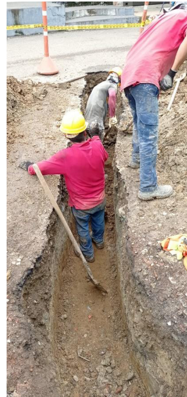
Caja de inspeccion.
