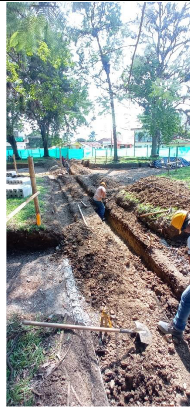
Tubería 8" para sumideros.
