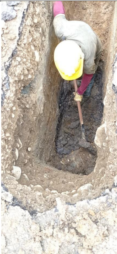
Caja de inspeccion.
