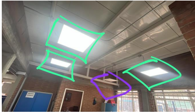
Foto 16. Problemas con luminarias
