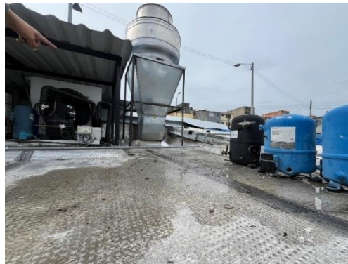
Foto 20. Filtraciones en cubierta.
