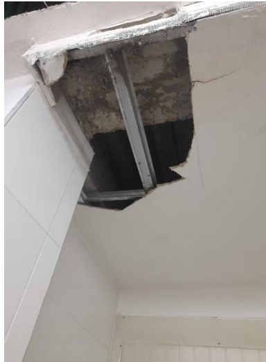
Foto 19. Filtraciones en cubierta.
