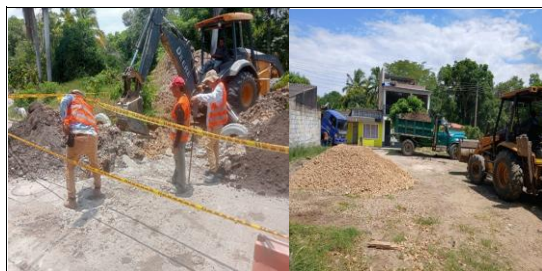
Aqua de Dios - alcantarillado
