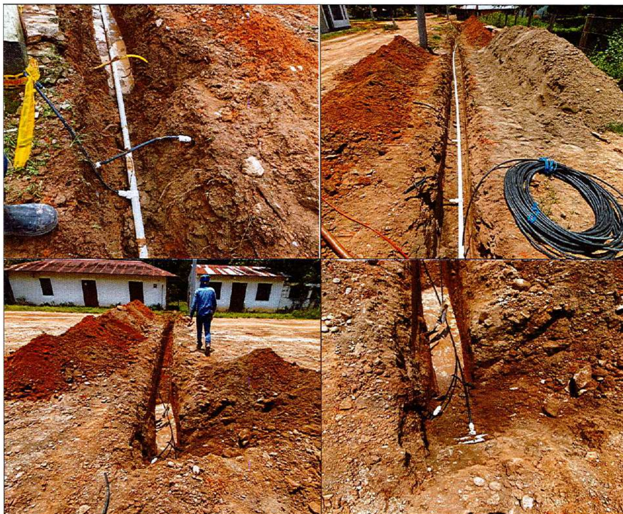
IMAGEN 13. ACOMETIDA DOMICILIARIA ACUEDUCTO
