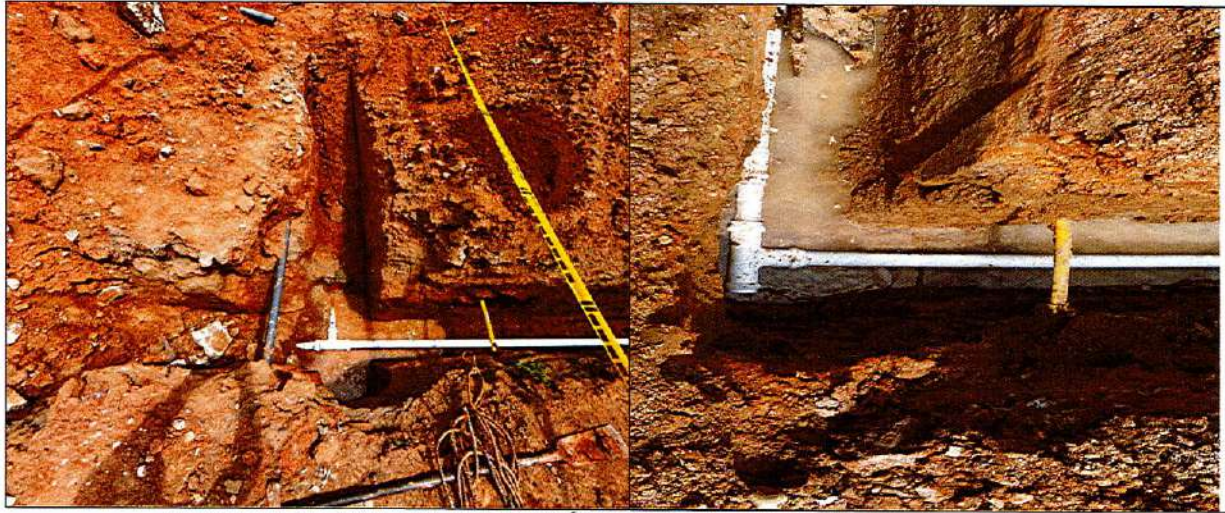
IMAGEN 12. TEE DE PRESIÓN PVC 2". SUMINISTRO E INSTAL.
