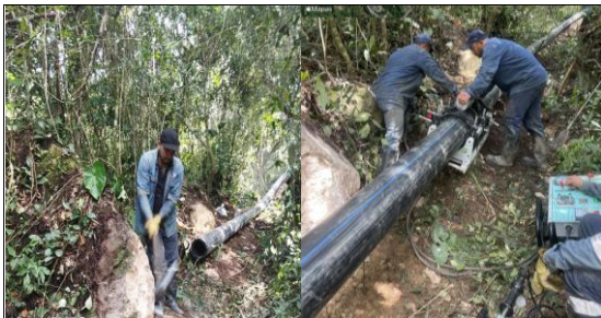
Guaduas - tubería de acueducto
