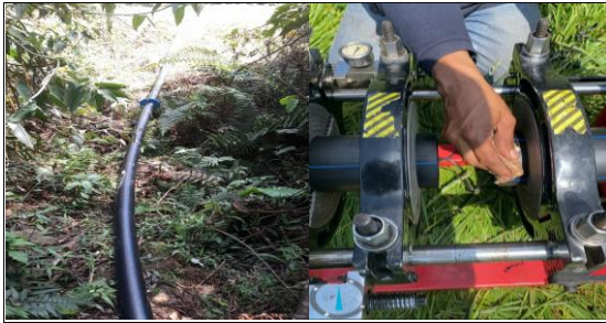
Silvania - tubería de acueducto
