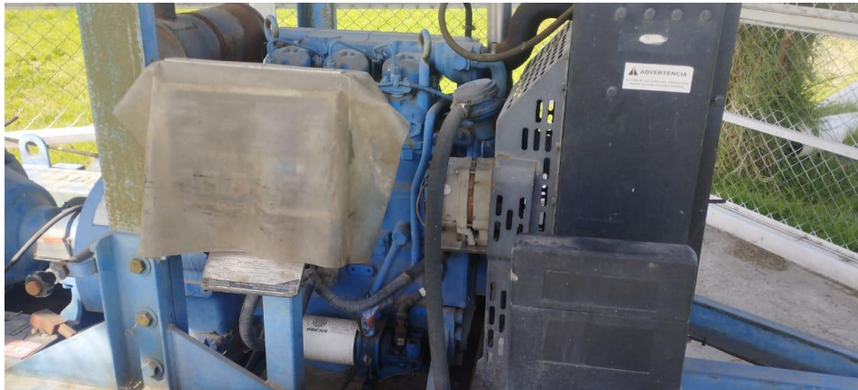
Figura 1. Punto de bombeo.
