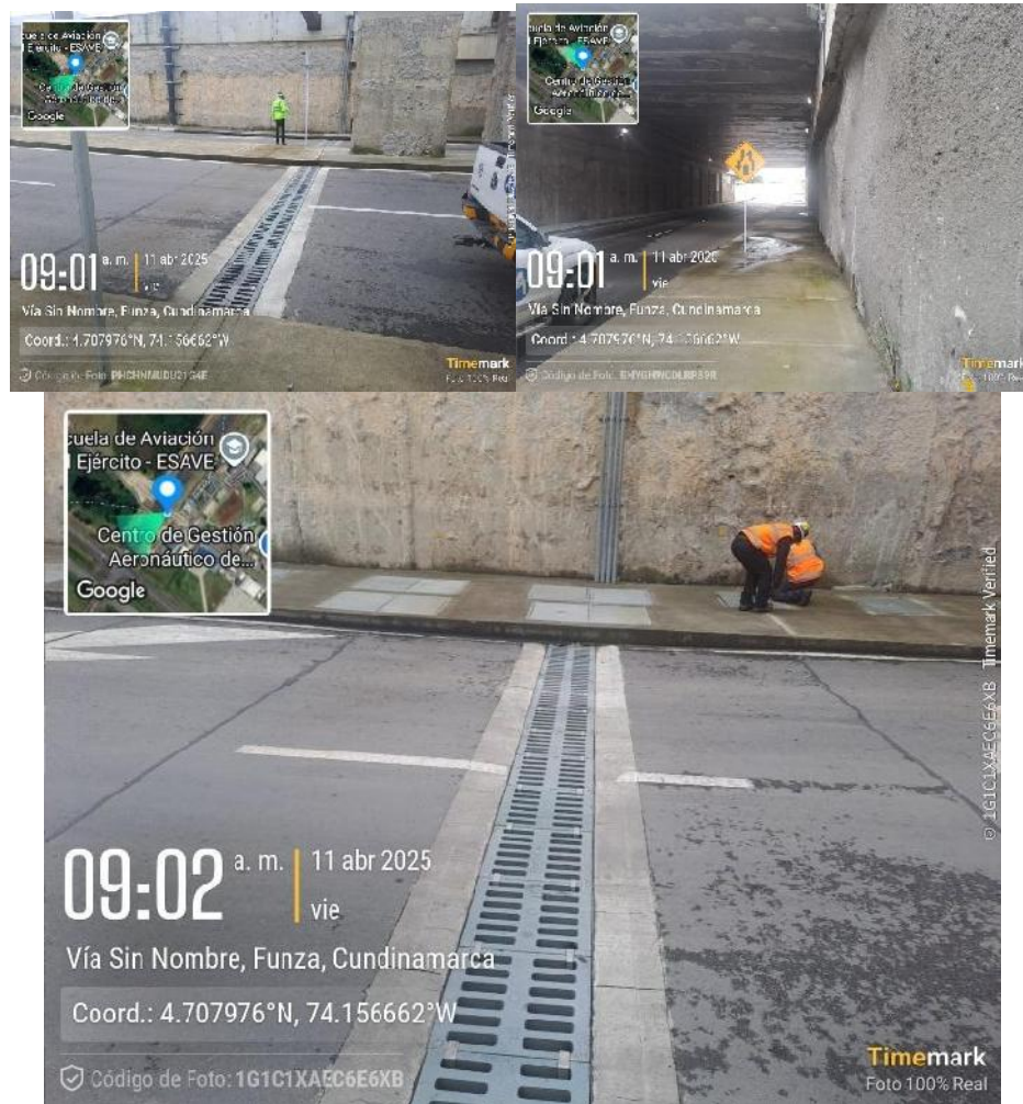
Figura 3. Estado general del deprimido Calle Lima. Demuestra normalidad y buen estado del drenaje de la calle de rodaje.
