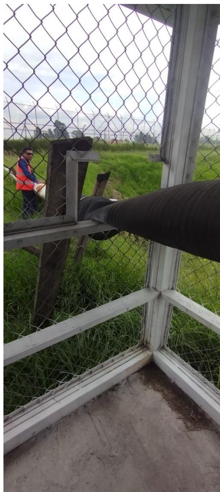
Figura 11. Maguera de salida de aguas.
