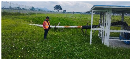
Figura 8. Apoyos de la descarga de la Bomba.
