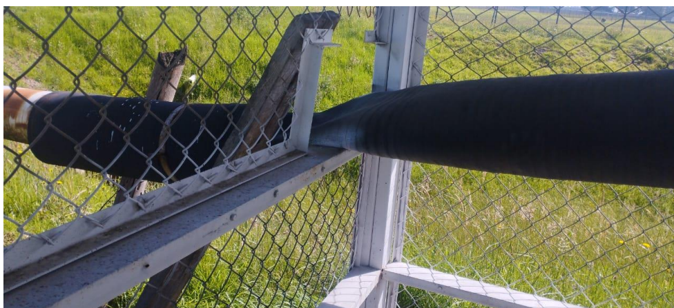
Figura 11. Manguera de salida de aguas.
