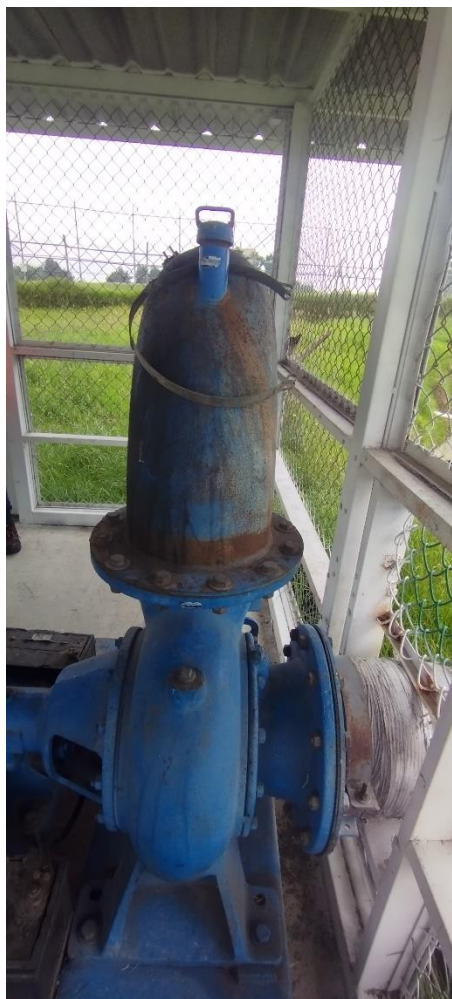
Figura 10. Caracol de bombeo.
