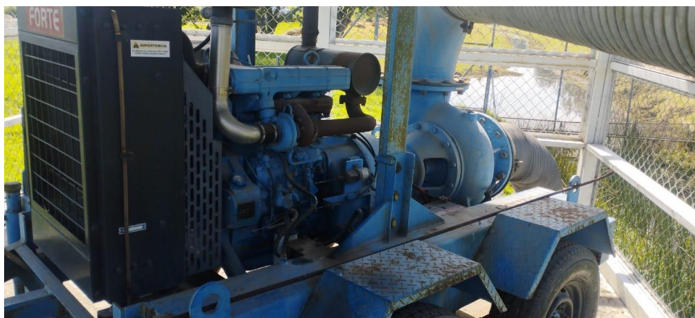
Figura 7. Equipo muy oxidado.
