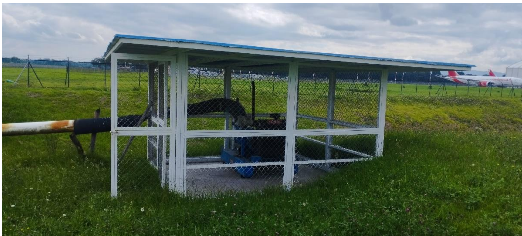
Figura 6. Punto de bombeo.
