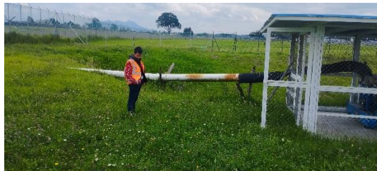
Figura 8. Descarga de la Bomba.
