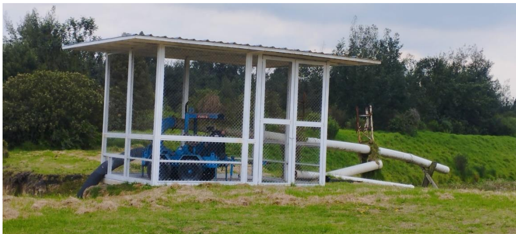
Figura 12. Punto de bombeo.
