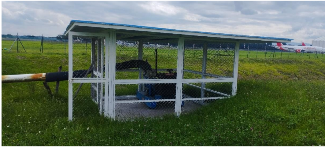
Figura 6. Punto de bombeo.
