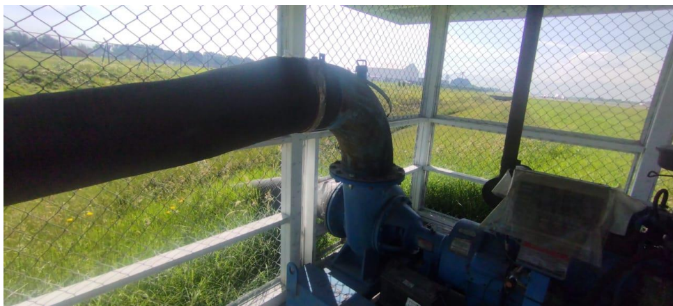
Figura 10. Caracol de bombeo.
