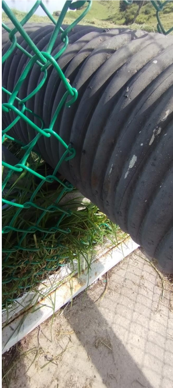
Figura 5. Manguera presenta fisuras por golpes.
