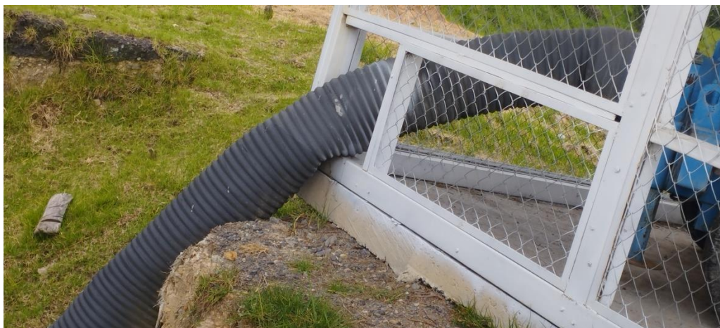
Figura 15. Manguera de succión con aplastamiento.
