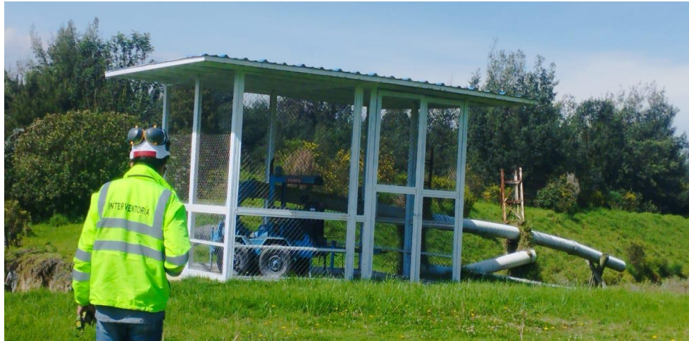
Figura 12. Punto de bombeo.
