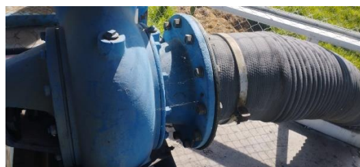
Figura 9. Equipo muy sucio y oxidado.
