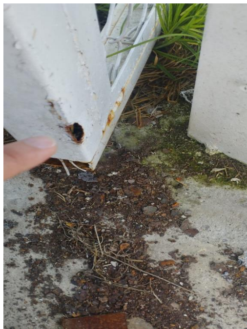
Figura 15. Rotura por oxidación.
