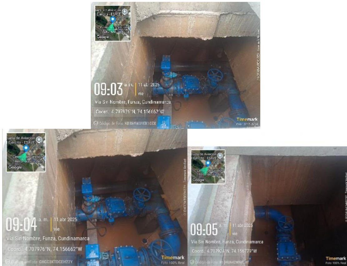
Figura 4. Estado general del sistema de bombeo Calle Lima. No presenta novedades sensores en su ubicación y nivel del agua por debajo de niveles críticos.
