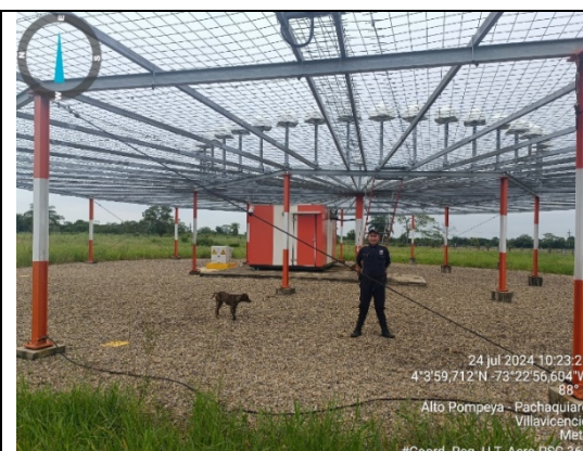
Vista este antena VOR de Pompeya – Meta, con unidad de seguridad.
