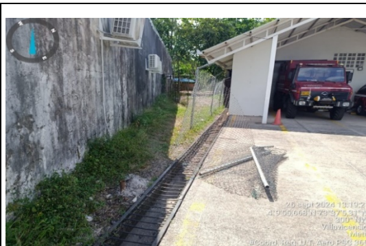
Imagen 2. Punto vulnerable por obra junto a instalaciones del SAR.
