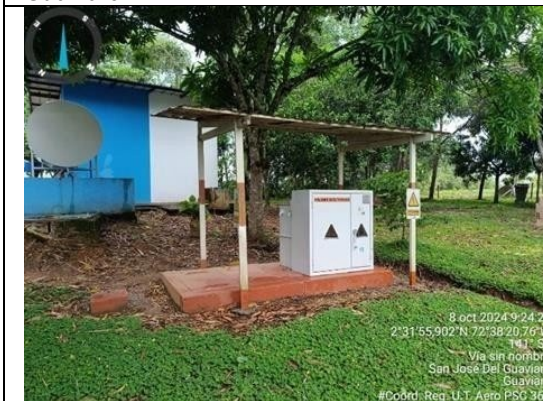
Combustible para planta eléctrica con barrera de contención.
