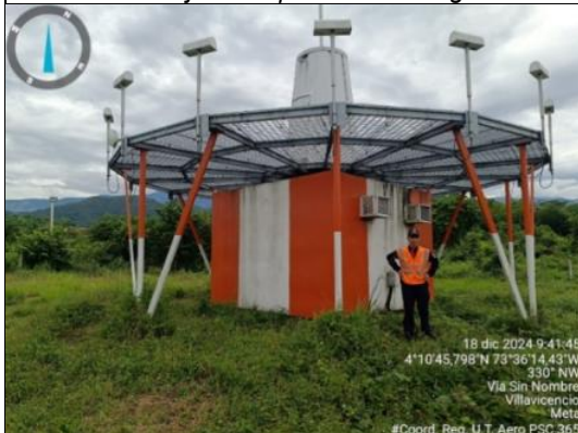
Instalaciones del VOR
