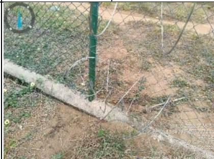
Imagen 17. Vista detalle donde averiaron la malla sector 3.
