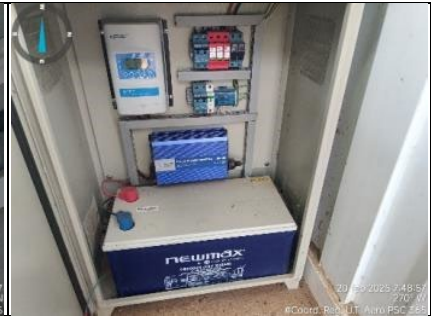
Imagen 3. Vista gabinete y equipos solución solar caseta puesto # 5.
