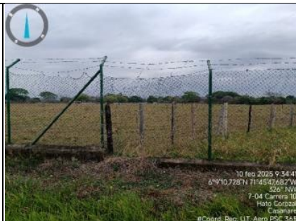
Imagen 12. Vista refuerzo con concertina sector 2 por daño de la malla.
