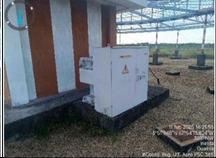
Imagen 6. Vista transformador de energia.
