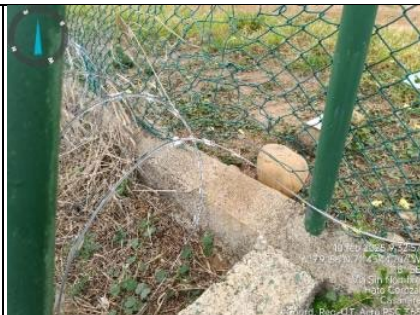
Imagen 11. Vista detalle donde averiaron la malla sector 1.
