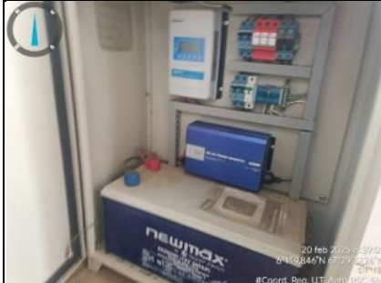
Imagen 10. Vista gabinete y equipos solución solar caseta puesto # 6.
