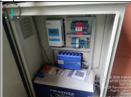
Imagen 17. Vista gabinete y equipos solución solar caseta del puesto # 4.
