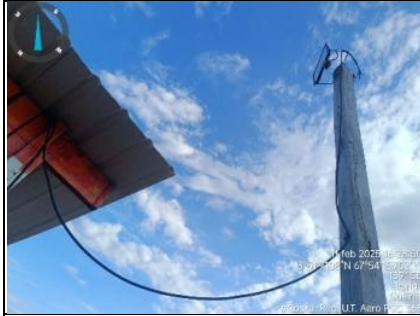
Imagen 13. Vista Sureste, reflector instalado junto a la caseta de vigilancia.
