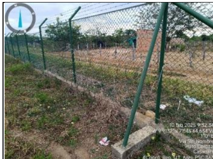
Imagen 10. Vista refuerzo con concertina sector 1 por daño de la malla.
