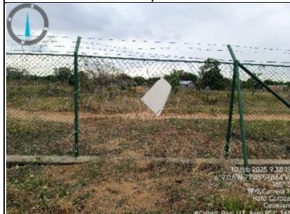
Imagen 16. Vista refuerzo con concertina sector 3 por daño de la malla.
