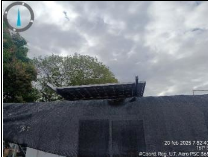
Imagen 4. Vista paneles solares caseta de vigilancia puesto # 5.
