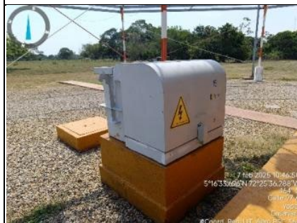
Imagen 4. Vista transformador de energía.
