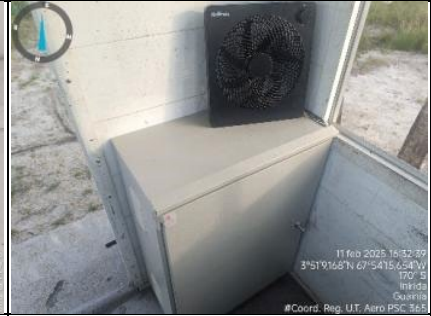
Imagen 15. Vista del gabinete y ventilador de la caseta.
