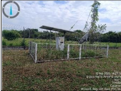
Imagen 13. Cerco, antena y sistema solar de equipos.
