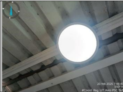
Imagen 2. Vista lampara interna caseta puesto # 5.
