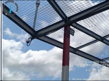
Imagen 32. Vista cámara 2 VOR/DME Mitú.
