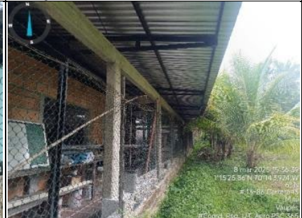
Imagen 12. Vista construcción que invadió predio de bomberos sobre el cerramiento.
