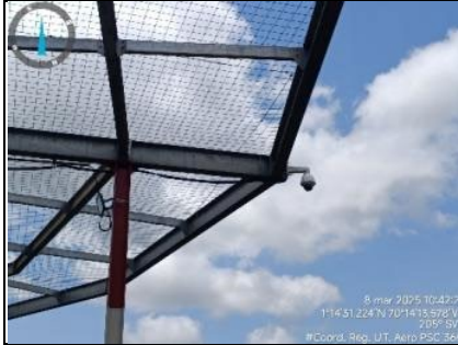
Imagen 31. Vista cámara 1 VOR/DME Mitú.
