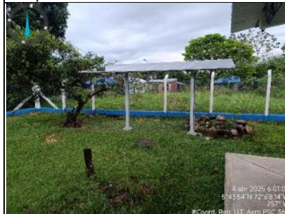
Imagen 4. Vista oeste paneles solares fotovoltaicos de solución solar.
