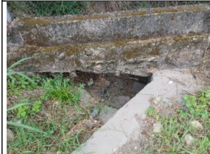
Imagen 46. Imagen de vulnerabilidad canal de desagüe encaramiento.
