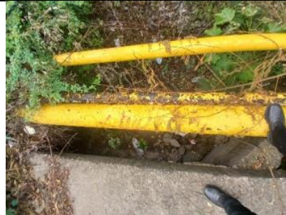
Imagen 44. Punto vulnerable canal desagüe
