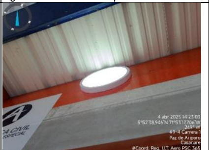
Imagen 12. Vista lampara externa de la caseta de vigilancia.
