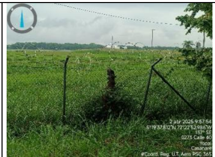
Imagen 3. Vista malla sur este, calle 40 concertina de seguridad en regular estado.
