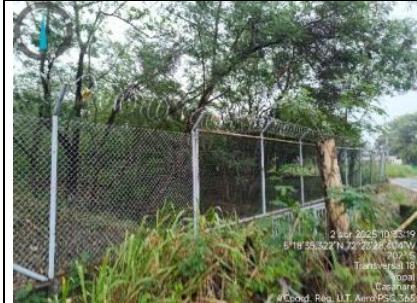
Imagen 10. Vista pileta de desagüe cerramiento perimetral sur occidente calle 48, regula estado.
