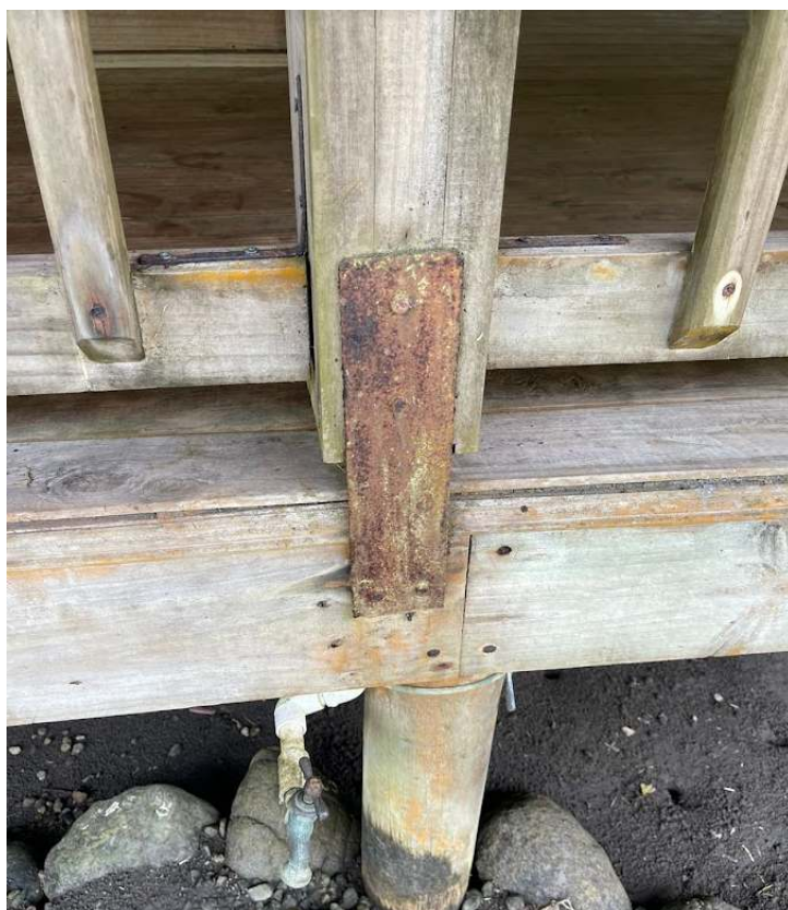
Imagen 13. Estado actual de las platinas de conexión de estructura del Restaurante. Fuente: Documento “DIAGNÓSTICO PRELIMINAR VISITA PNN UTRÍA” – Carlos Manuel Olarte Martínez
