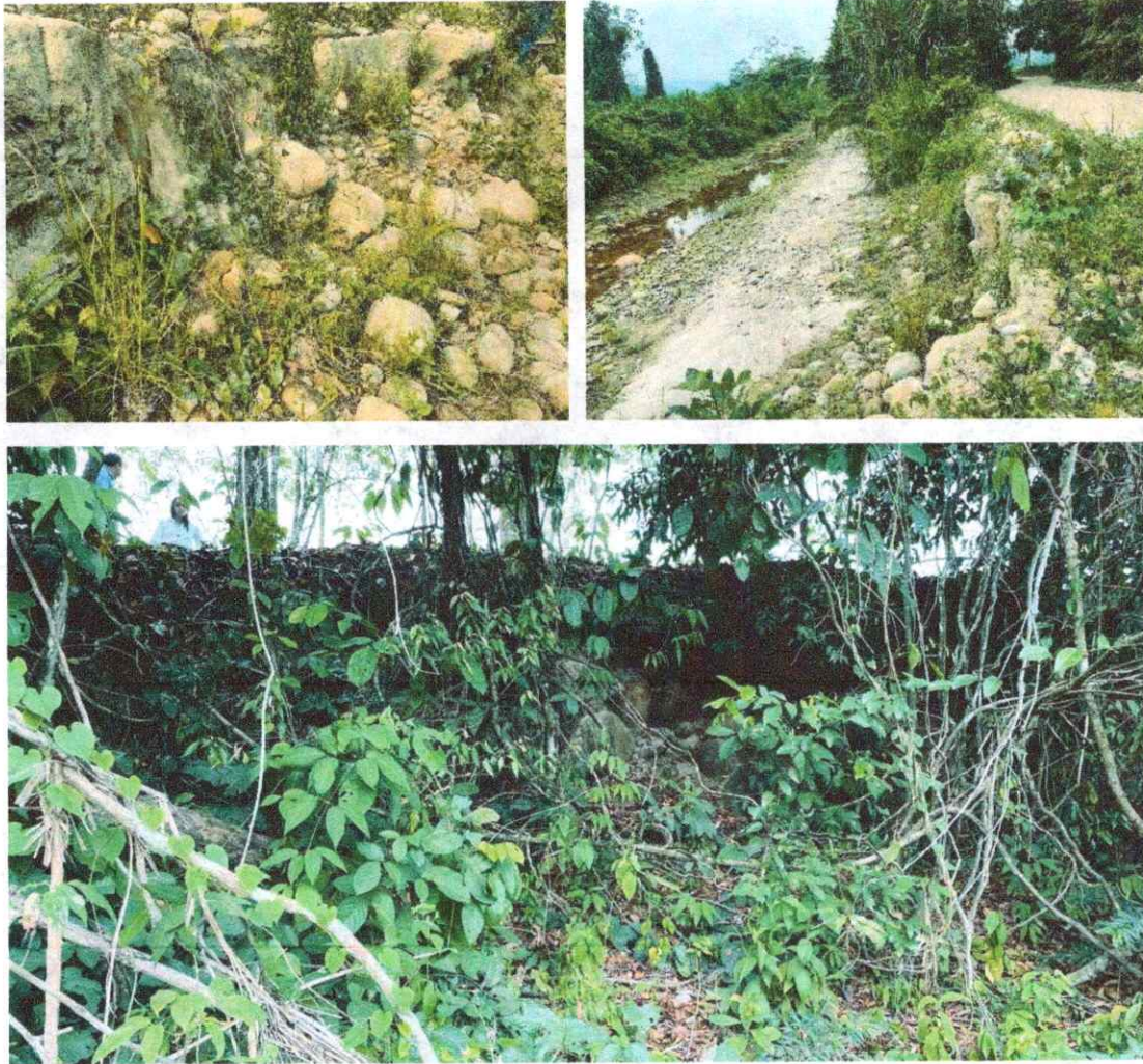
Fotografía 2. Estado de zonas erosionadas
