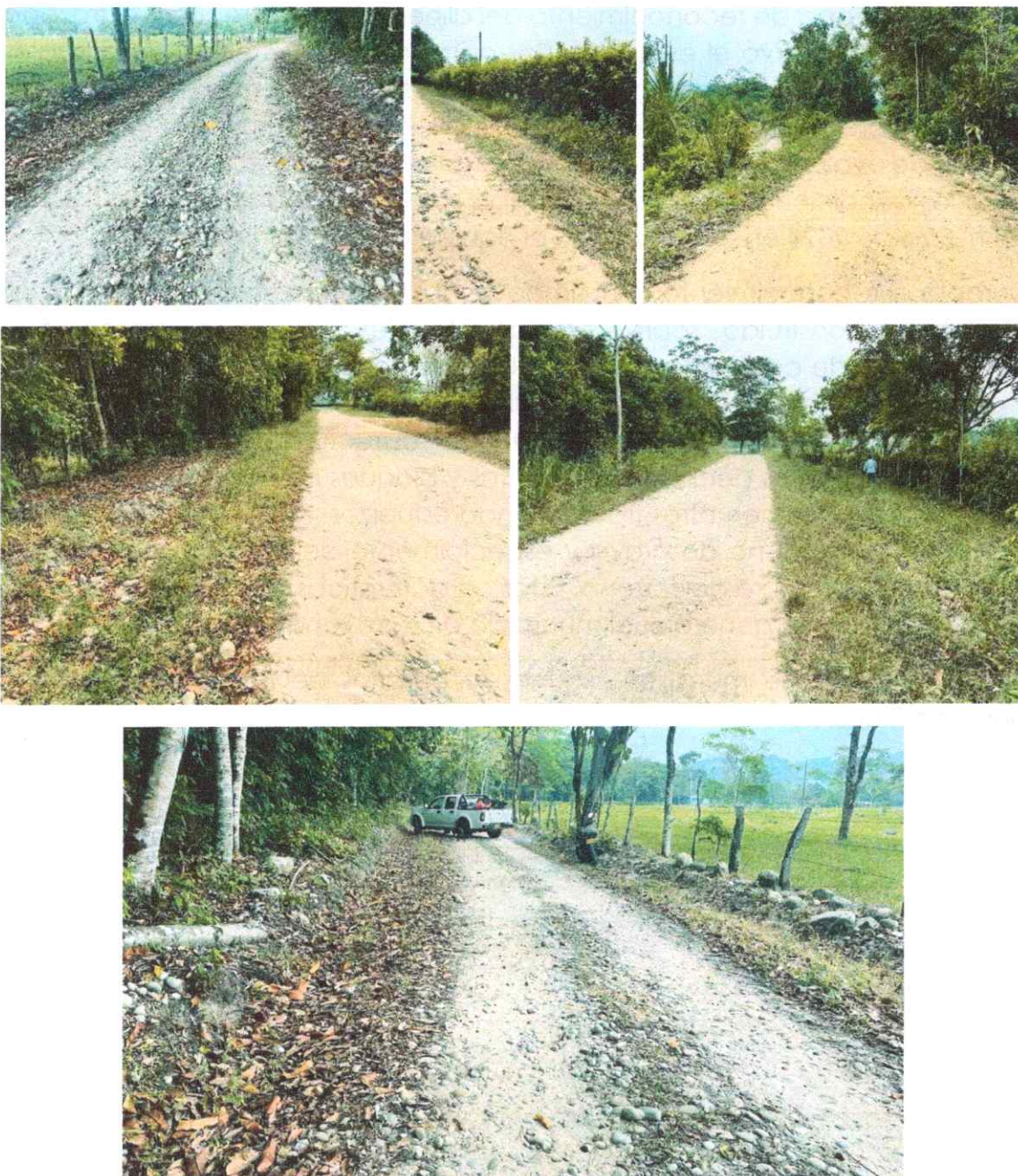
Fotografía 1. Estado típico actual de la vía
