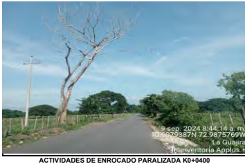
ACTIVIDADES DE ENROCADO PARALIZADA K0+0400
