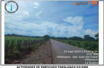
ACTIVIDADES DE ENROCADO PARALIZADA K0+0400
