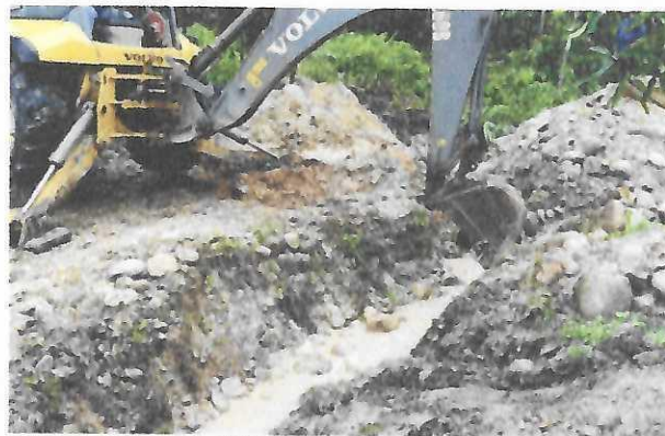
Figura 29. Drenaje de aguas lluvias.
