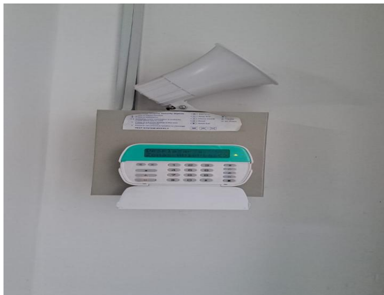
Imagen 7. Sistemas de alarmas de la bodega
