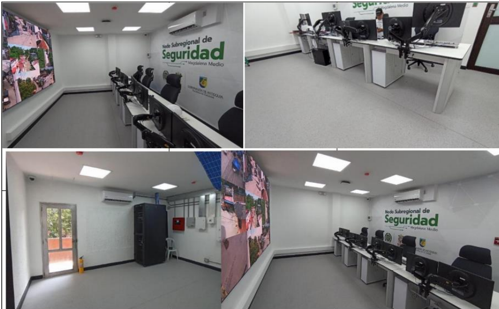
Ilustración 1. Estado actual de las paredes del centro monitoreo de Puerto Berrio.
